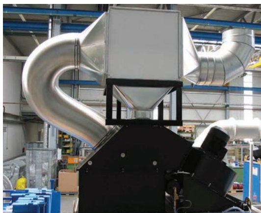
Wärmerückgewinnung verschmutzte Abluft / Luft
