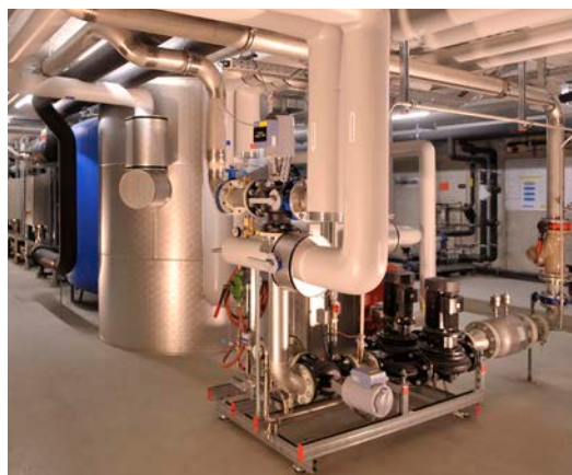
Abwärmenutzung Kältemittel / Wasser
