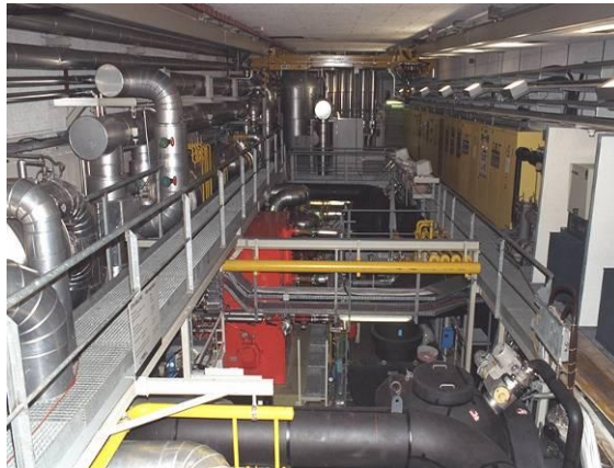
Wärmepumpe ETHZ Walche 10 MW
