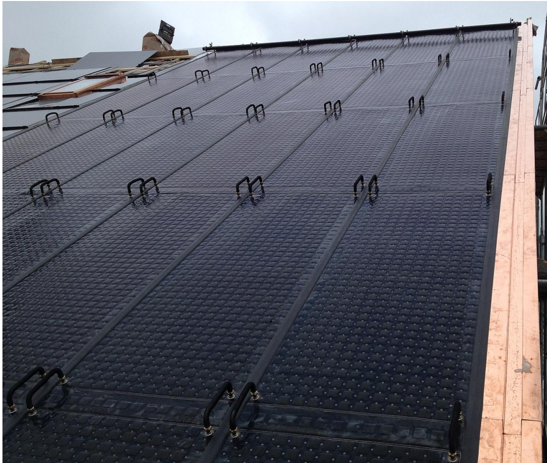
Abb. 3: Solardach mit unverglasten Kollektoren von Energie Solaire SA als Wärmequelle für die tieftemperaturige Saisonspeicherung in den Erdwärmesonden.
